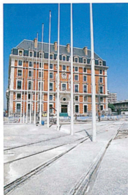
▲ Intégrés au béton désactivé de la place, les anciens rails reposent sur un renfort sous dalle.
